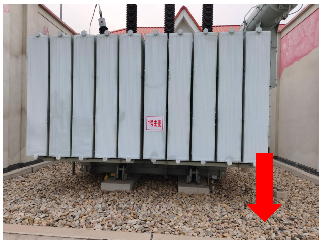
洪爽 110kV 变电站#1 主变压器及事故油坑 (原有)
