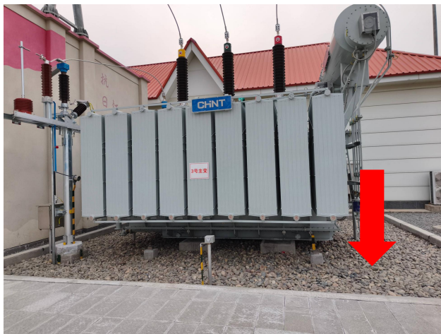
洪爽 110kV 变电站#3 主变压器及事故油坑 (本期)
