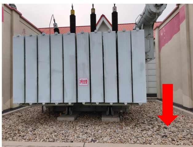
洪爽 110kV 变电站#2 主变压器及事故油坑 (原有)
