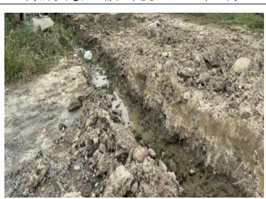
塔基区临时排水沟 (2025 年 6 月)
