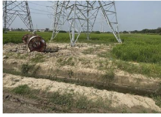
塔基区临时排水沟（2025年9月）
