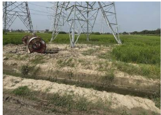
塔基区临时排水沟（2025年9月16日）
