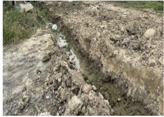
塔基区临时排水沟（2025年6月24日）
