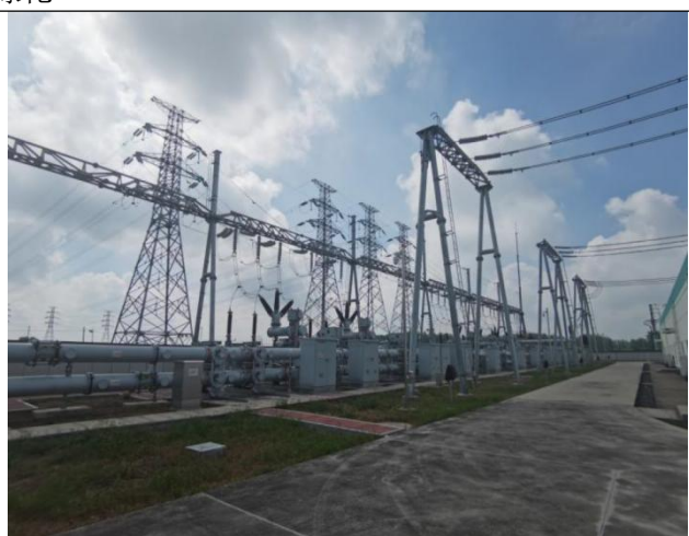
110kV 配电装置
