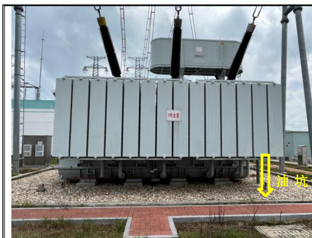
前期#1 主变及事故油坑
