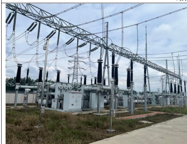
220kV 配电装置
