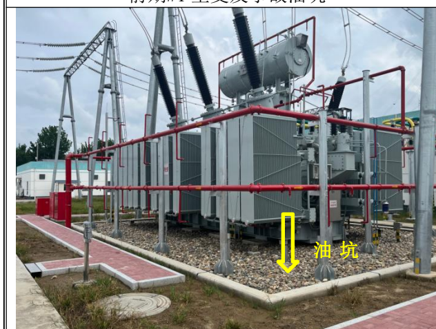
本期#2 主变及事故油坑
