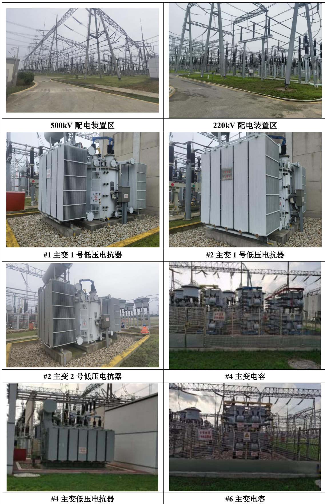
图 3-1 上党 500kV 变电站原有工程 (b)
