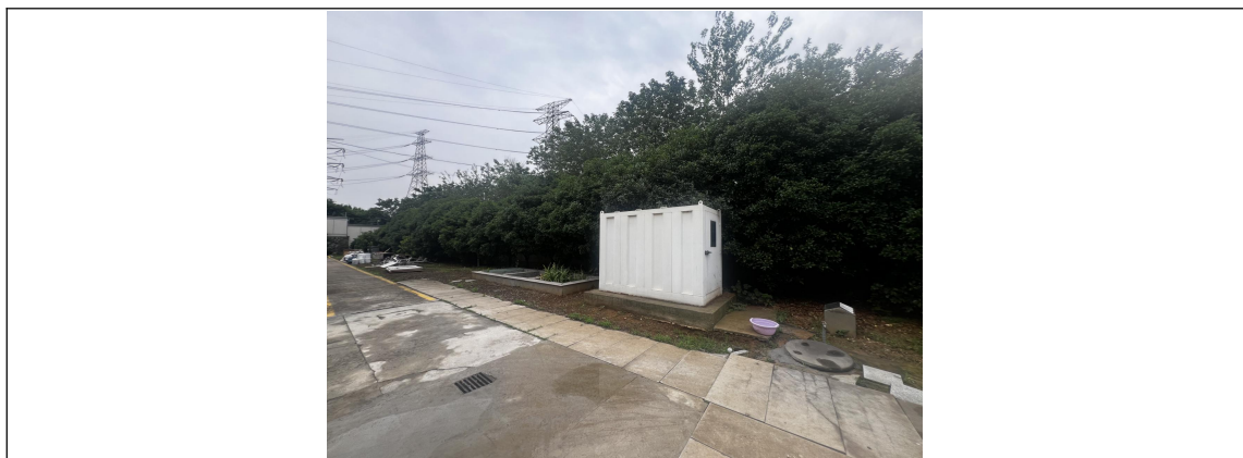
图 9-1 上党 500kV 变电站内景观式一体化污水处理装置
