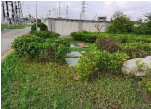
原有事故油池（#4 主变南侧）
