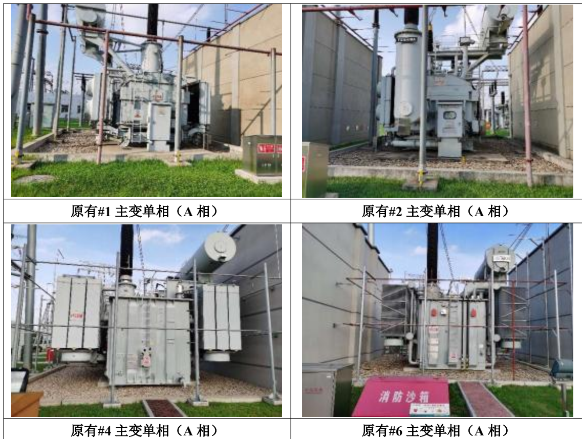
图 3-1 上党 500kV 变电站原有工程（a）
