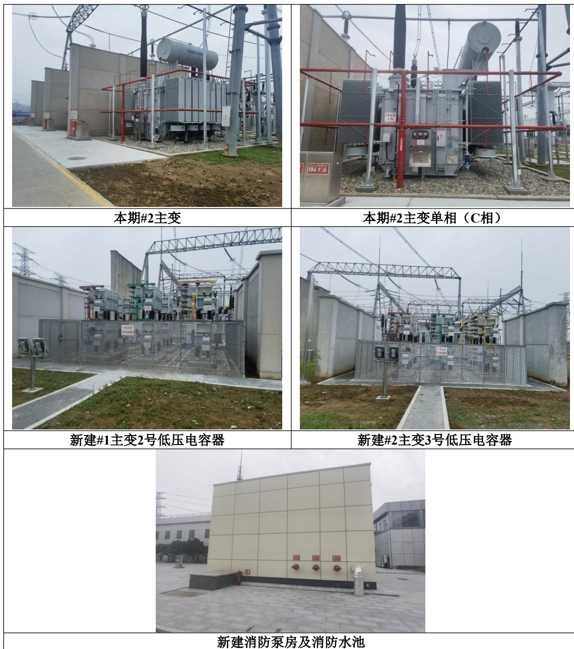
图3-3 上党500kV变电站本期工程
