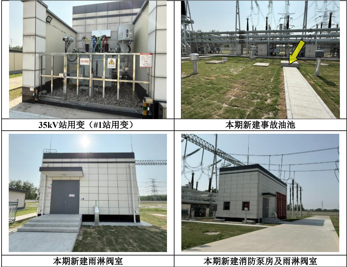
图3-1-3 沭阳500kV变电站本期工程照片
