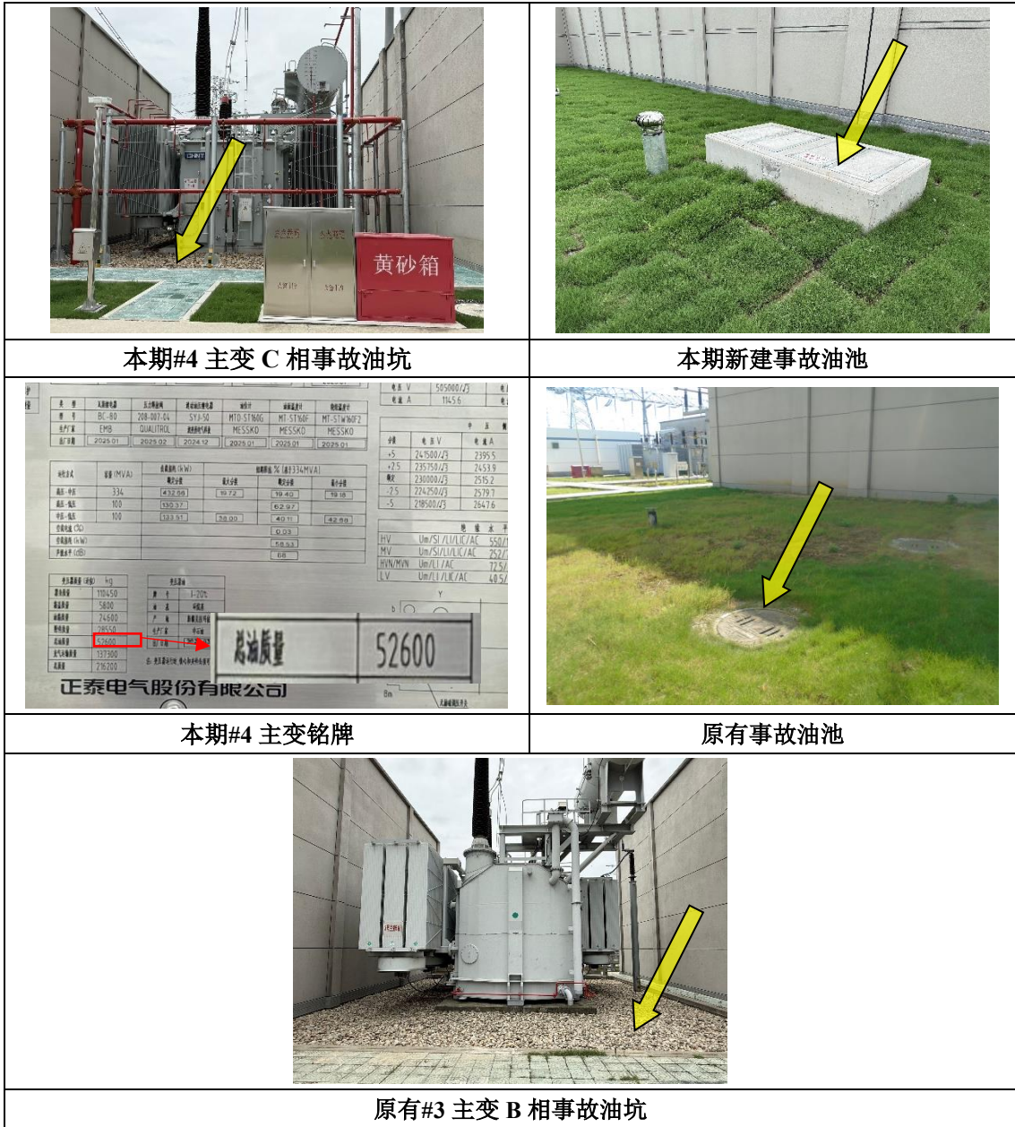
图 11-1 本期主变、低压电容事故油池（坑）及铭牌照片
