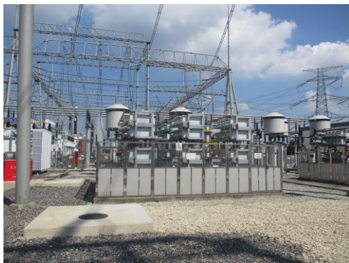
5 号主变 2 号电容器
