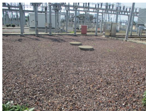
已有事故油池（220kV）
