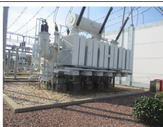
#3 主变已有事故油坑及防火墙
