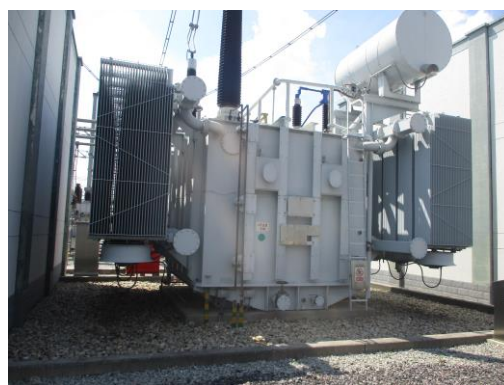
#6 主变已有事故油坑及防火墙
