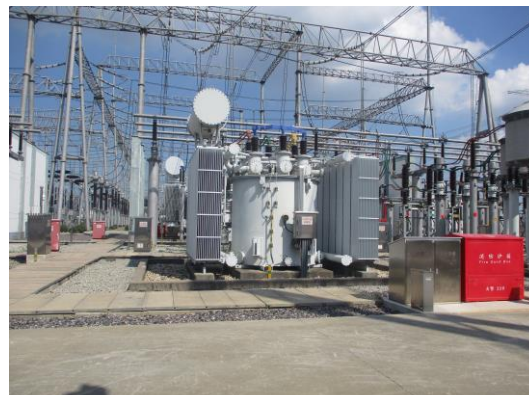
5 号主变 4 号低抗已有事故油坑
