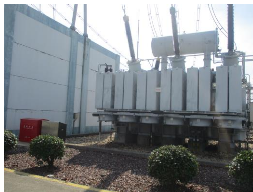
#4 主变已有事故油坑及防火墙
