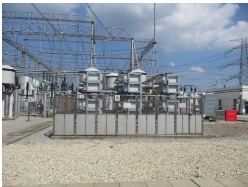
5 号主变 1 号电容器
