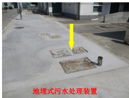
图 9-2 站内地埋式污水处理装置
