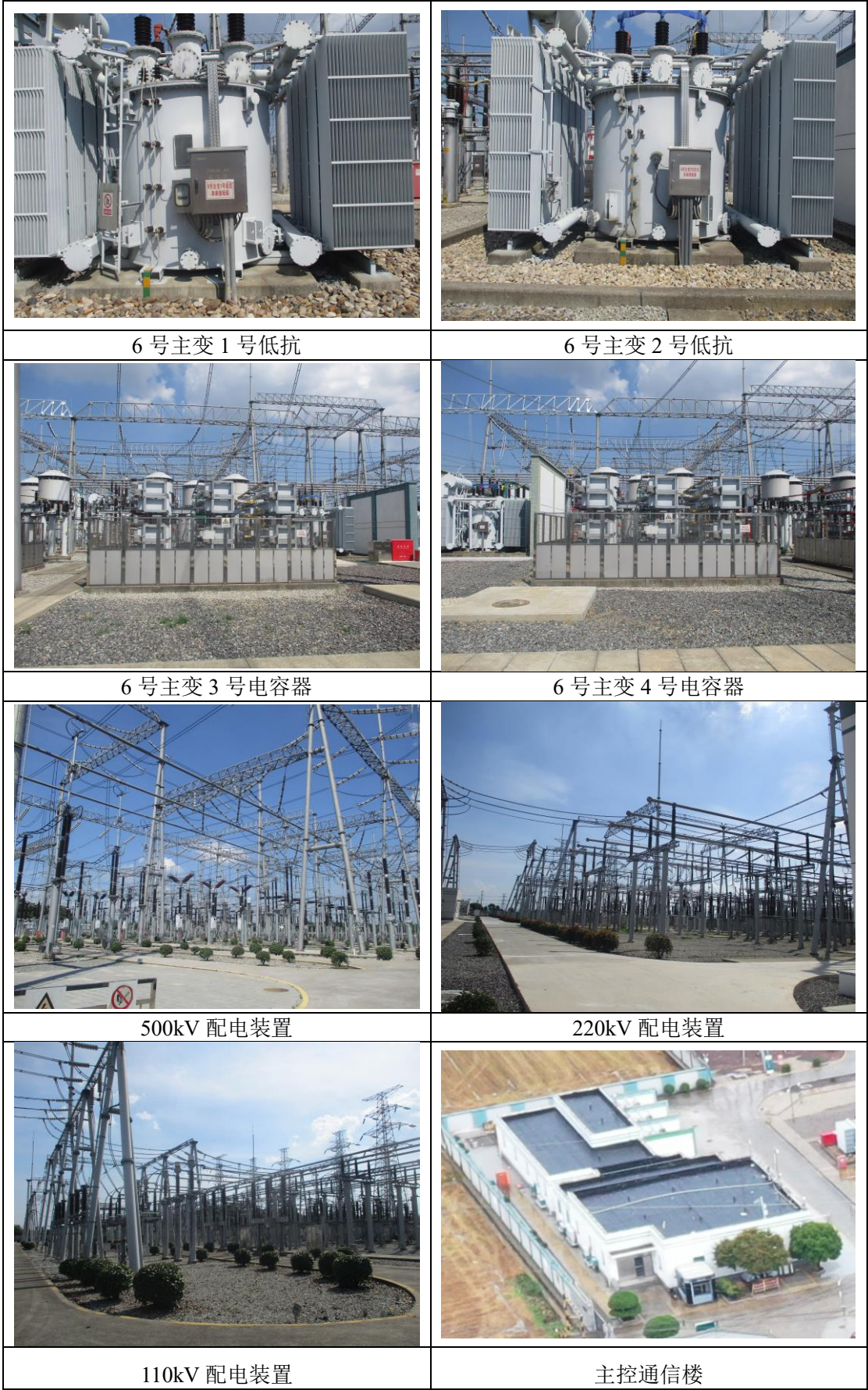
图 3-2 变电站前期规模设施照片
