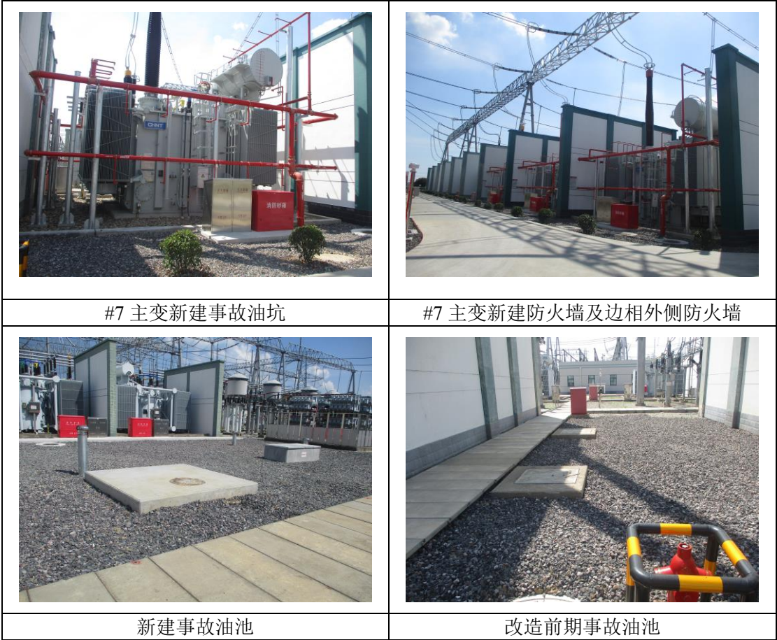
图 11-1 茅山 500kV 变电站本期新建事故油坑、事故油池及防火墙
