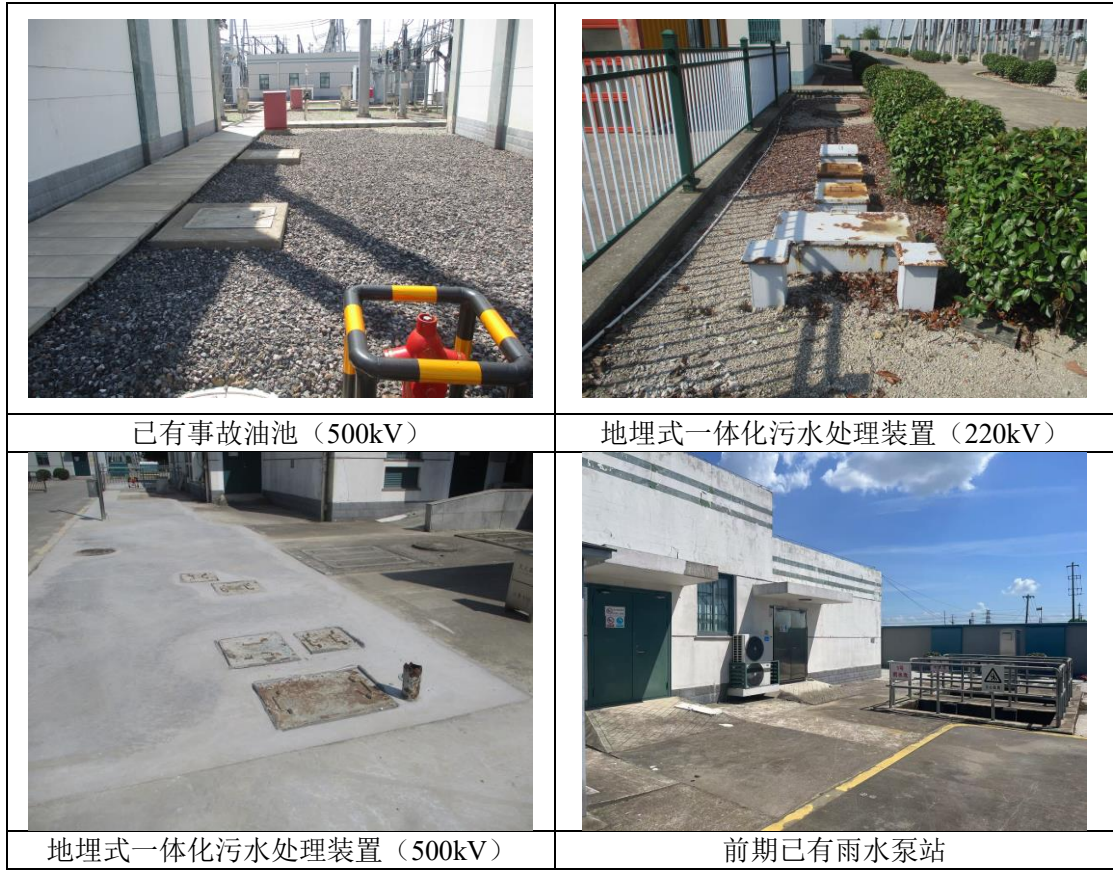
图 3-3 变电站前期环保设施照片
