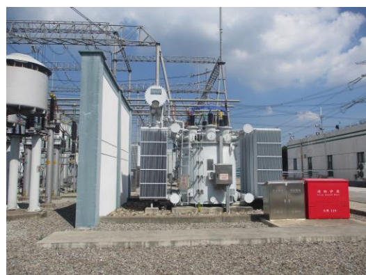
5 号主变 3 号低抗已有事故油坑及防火墙
