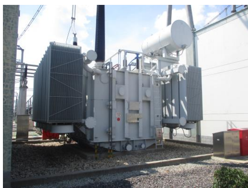
#5 主变已有事故油坑及防火墙
