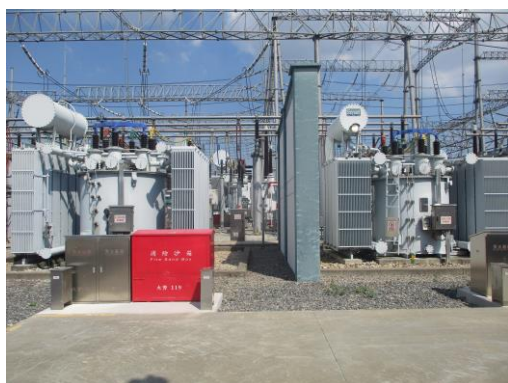
6 号主变 1 号、2 号低抗已有事故油坑 及低抗之间防火墙
