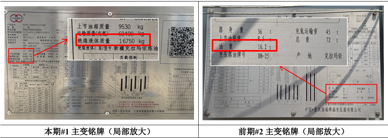
图 8.1 临洪 110kV 变电站主变铭牌照片
