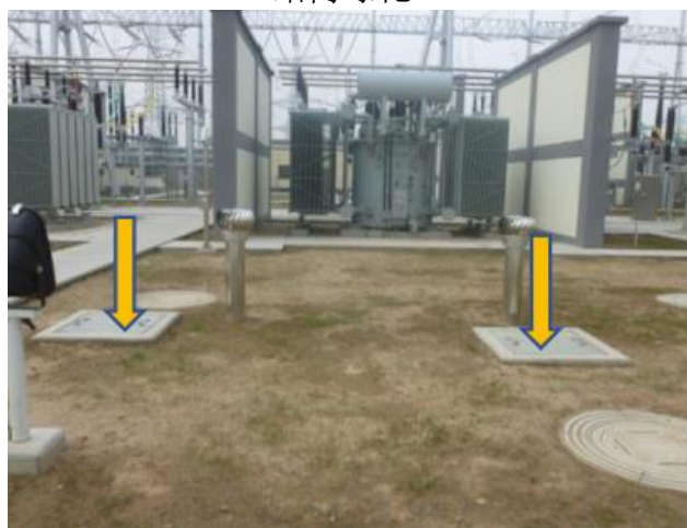
电抗器事故油池
