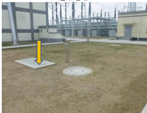
主变压器事故油池
