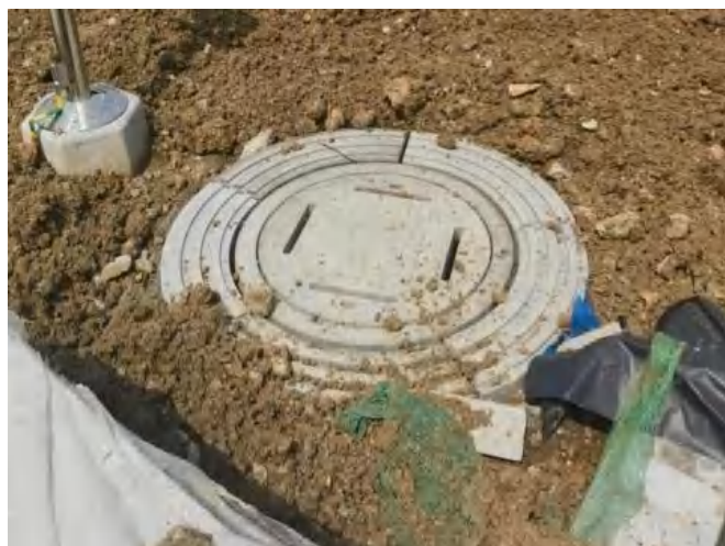
变电站区排水管网 (2024.1)
