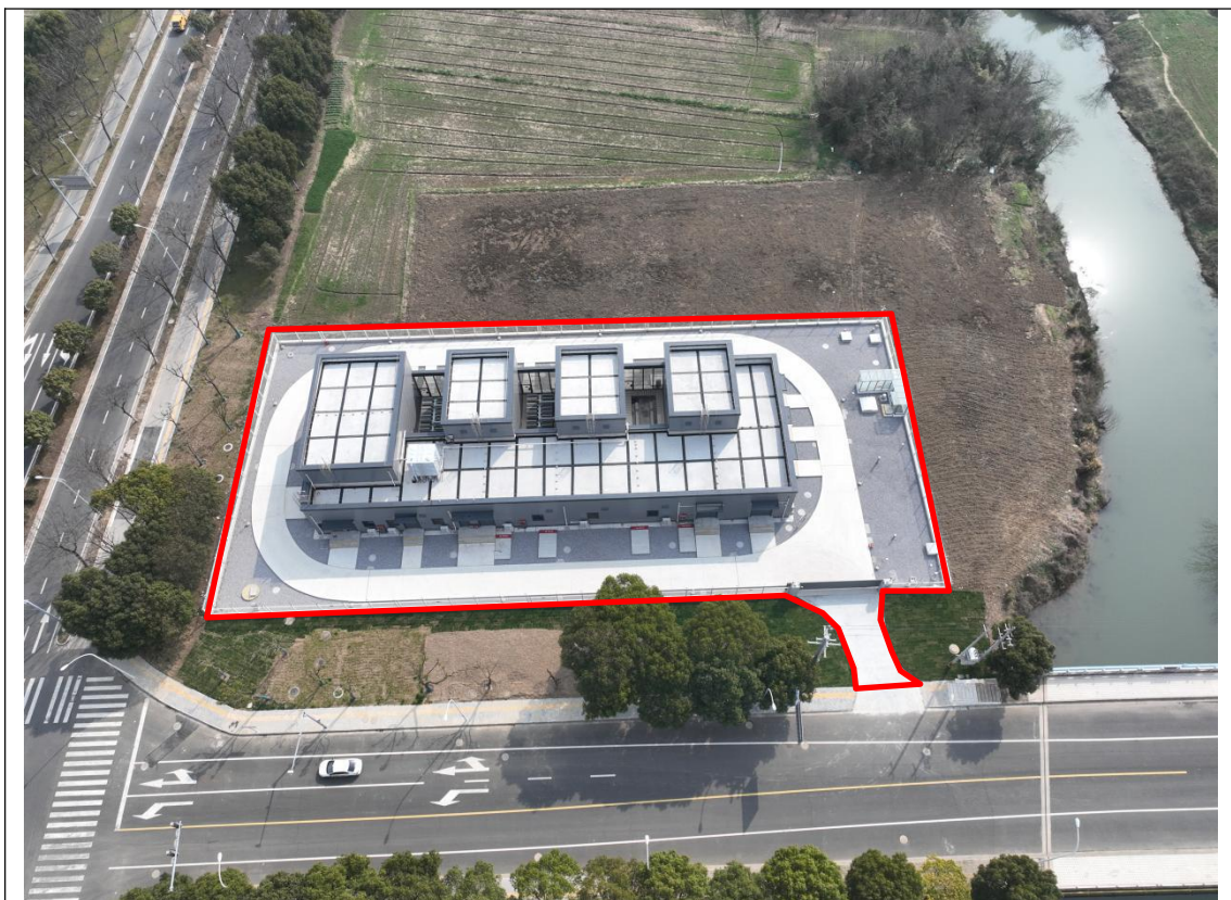
陈更变电站碎石压盖
