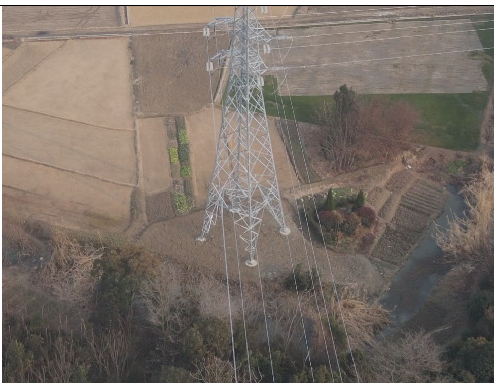
35kV 新能 358 线#8/110kV 典金 9Y8 线#29 塔建设后影像
