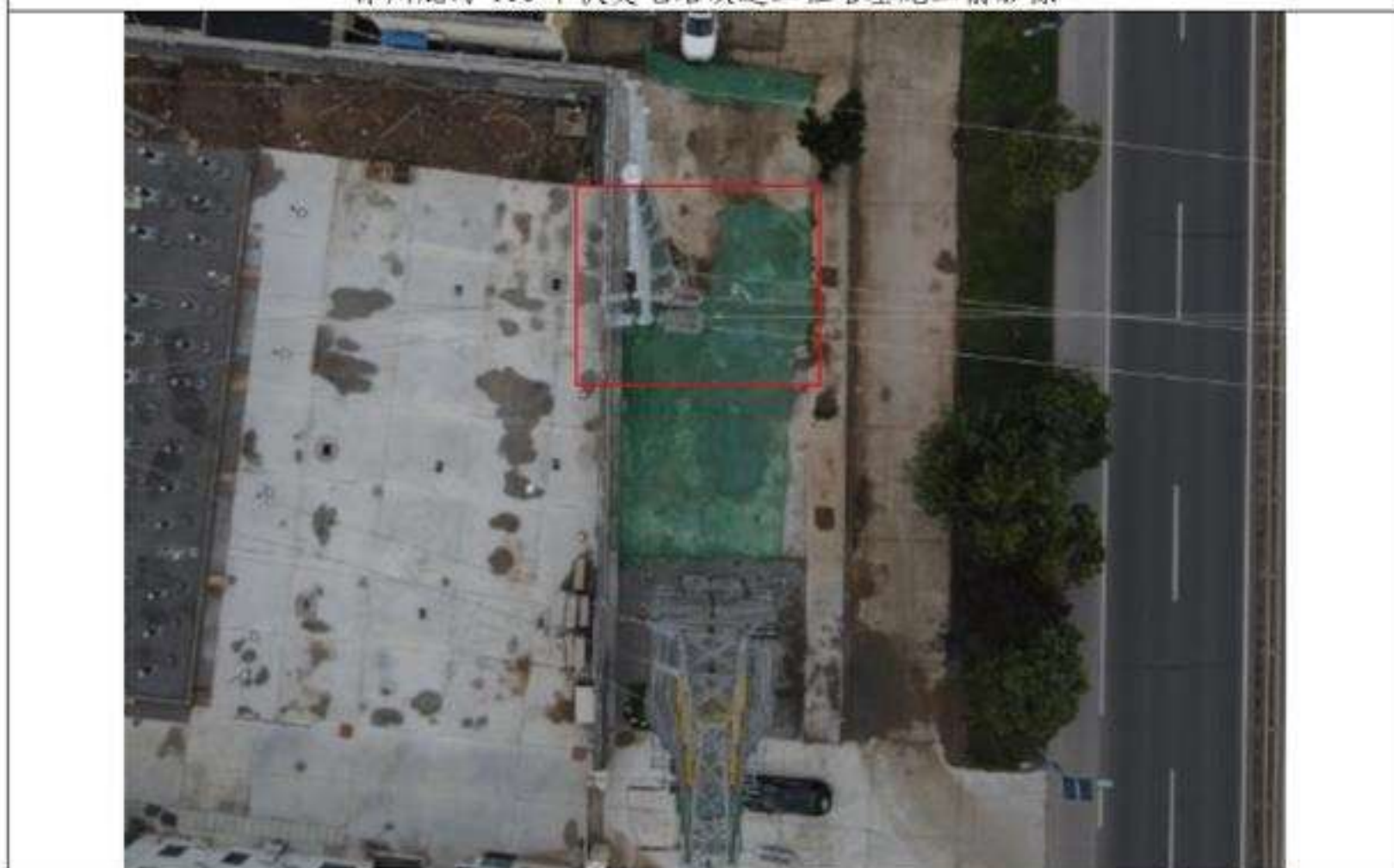
徐州鹿湾 110 千伏变电站改造工程施工后影像
