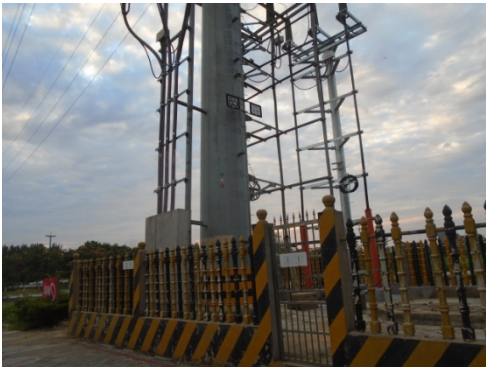
图 6-1 本期线路电缆终端塔照片
