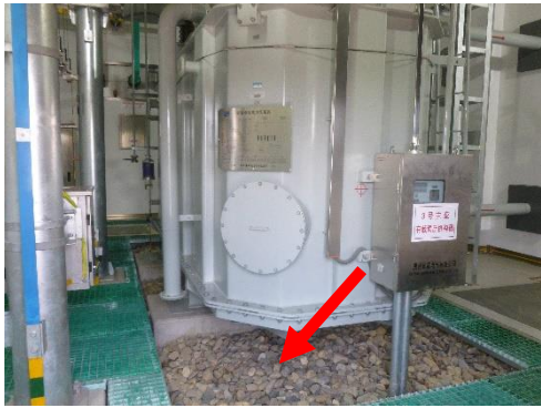
本期#3 主变事故油坑照片
