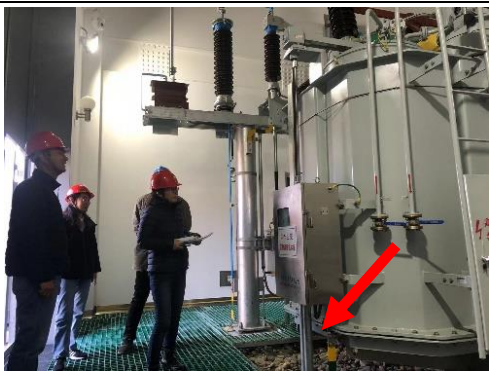
本期#1 主变事故油坑照片
