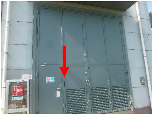
图6-2 110kV钱资湖变主变室外隔声门照片
