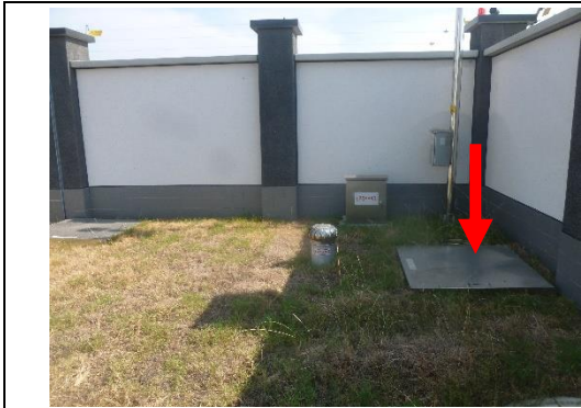
110kV 钱资湖变事故油池
