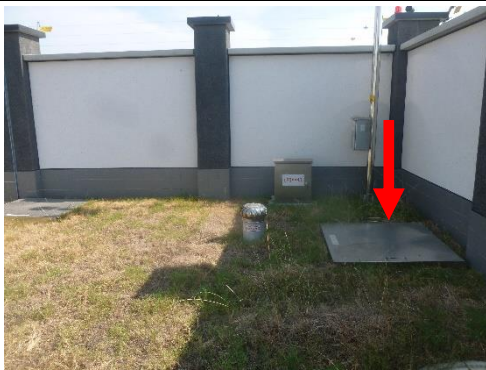
图 6-4 110kV 钱资湖变事故油池照片
