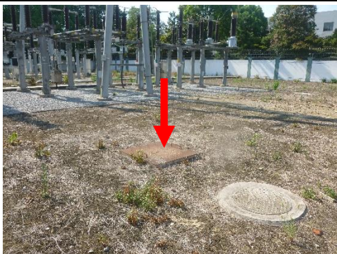
110kV 凤林变事故油池
