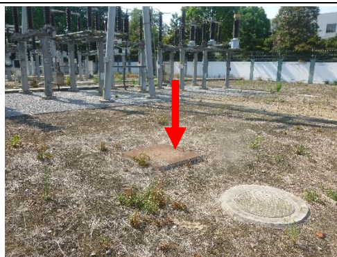
图6-3 110kV凤林变事故油池
