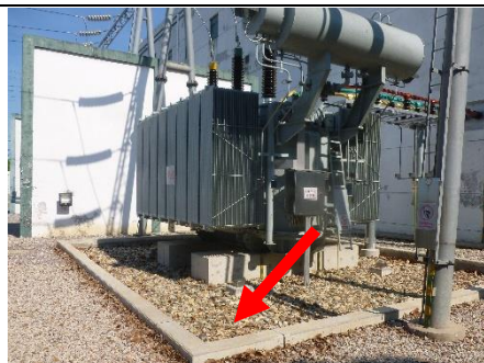
本期#3 主变事故油坑照片
