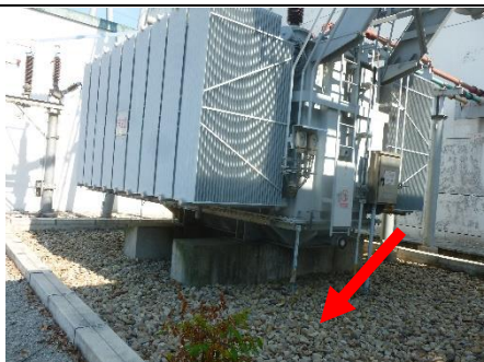
已验收#2 主变事故油坑照片
