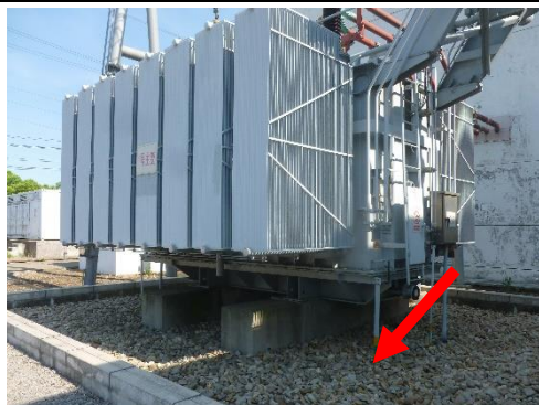
已验收#1 主变事故油坑照片
