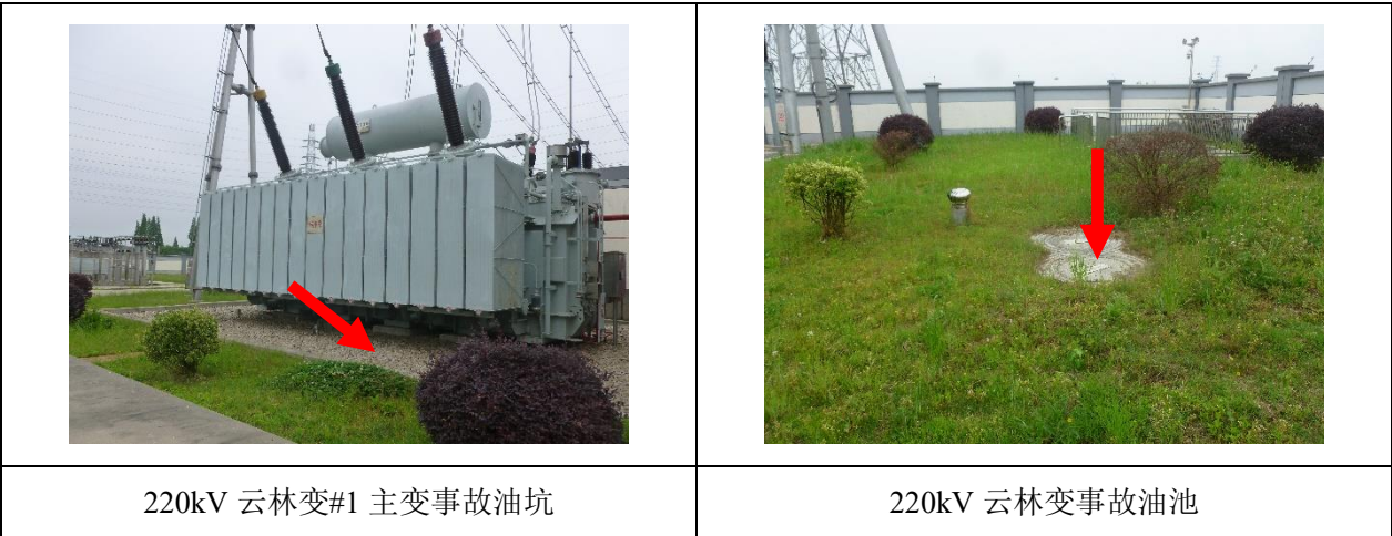
图 8-4 本工程 220kV 云林变事故油池照片
