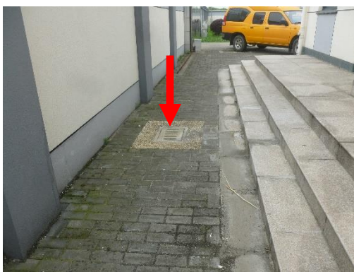
图 8-3 220kV 云林变化粪池照片
