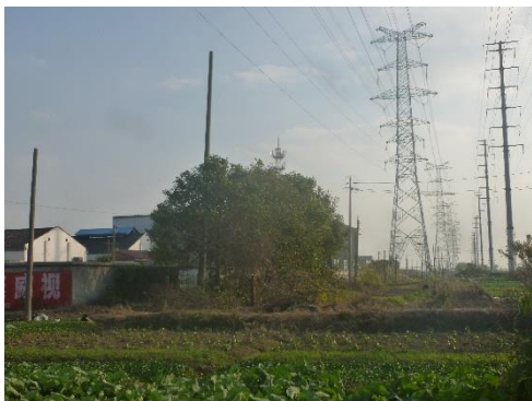
图6-1 本工程同塔多回架空线路
