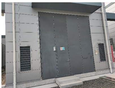
110kV 刁网变主变室隔声门
