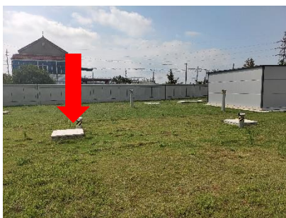
110kV 刁网变事故油池
