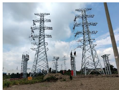
110kV 输电线路采用双设单挂和电缆敷设
