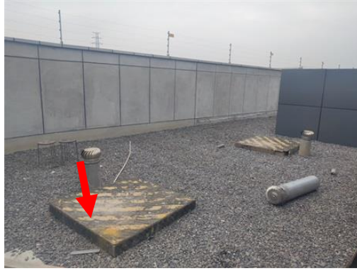
110kV 新丰开关站事故油池
