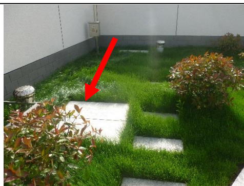
110kV 别桥变电站事故油池
