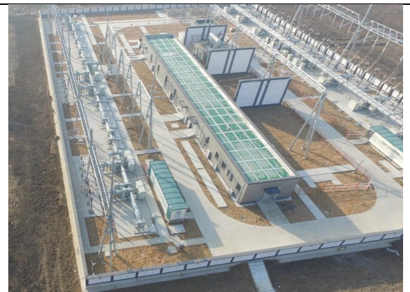
220kV 御密变 (2021 年 1 月)
