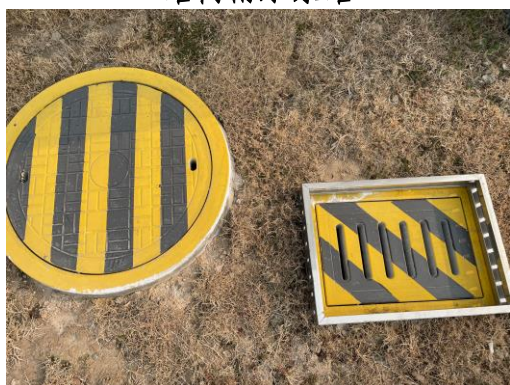
站内雨水井、检查井
