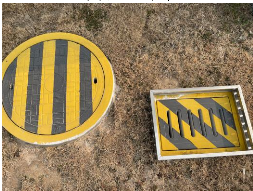
站内雨水井、检查井
