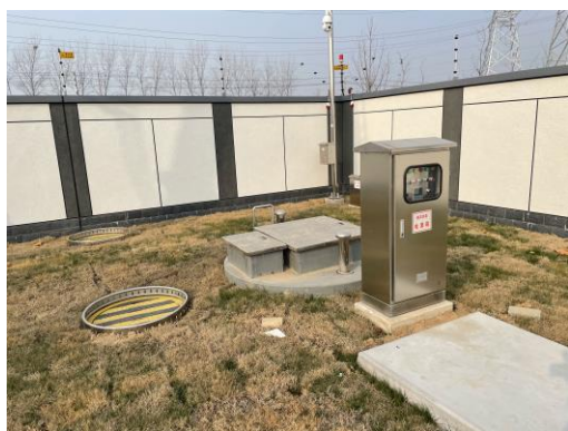
站内雨水泵站
