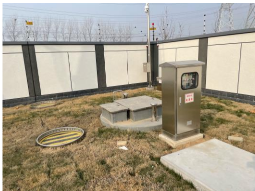
站内雨水泵站
