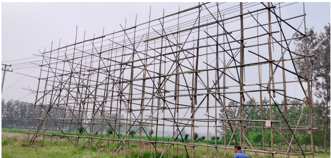
T19-T20 跨越低压线
