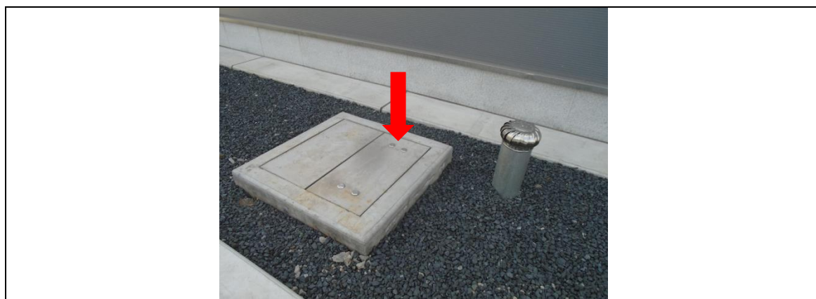
110kV 迎瑞变电站事故油池
