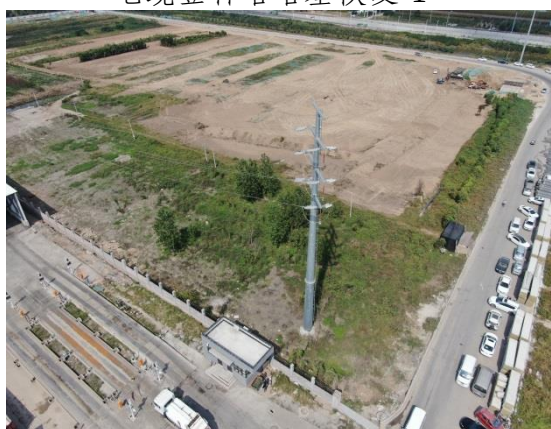
线路接入垃圾焚烧电厂终端塔
