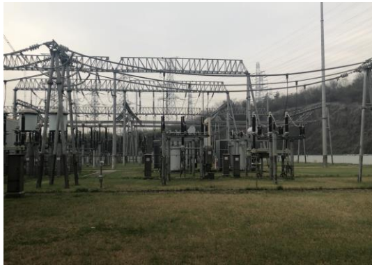
现有 220kV 配电装置区
