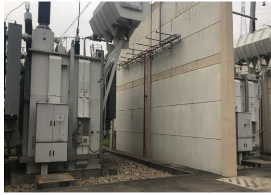
现有#2 主变（本期拟更换主变）
