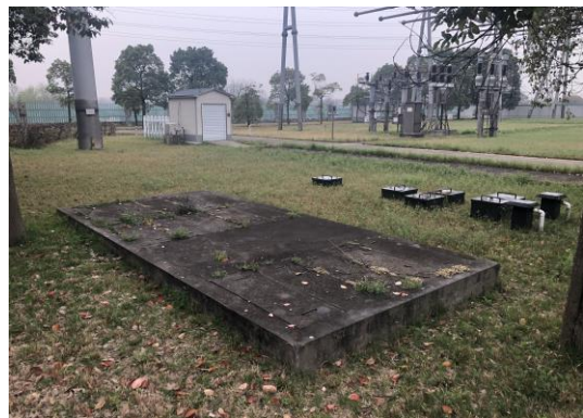
已建污水处理装置
