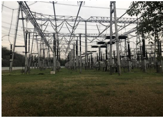
现有 500kV 配电装置区
