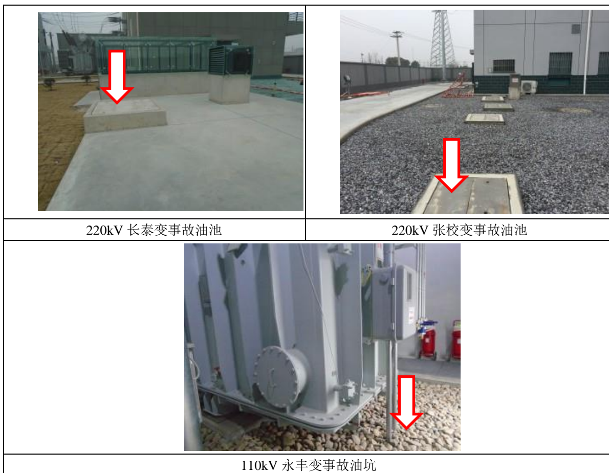
图 6-4 各变电站事故油池(坑)照片
