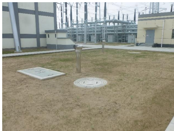
图 12-3 滨响 500kV 变电站事故油池
