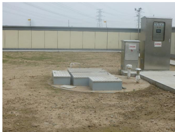
图 9-2 滨响 500kV 变电站内地埋式生活污水处理装置照片
