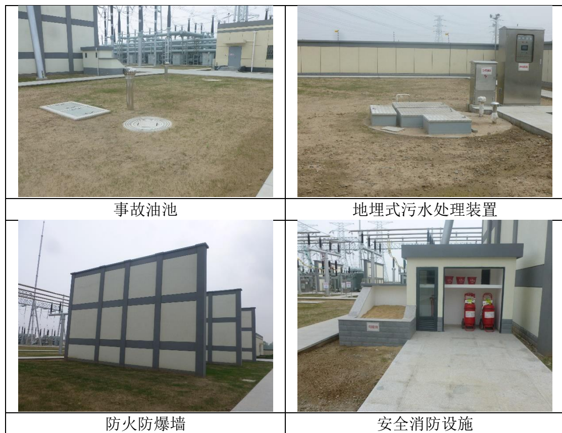
图 3-2 滨响 500kV 变电站原有工程环保设施
