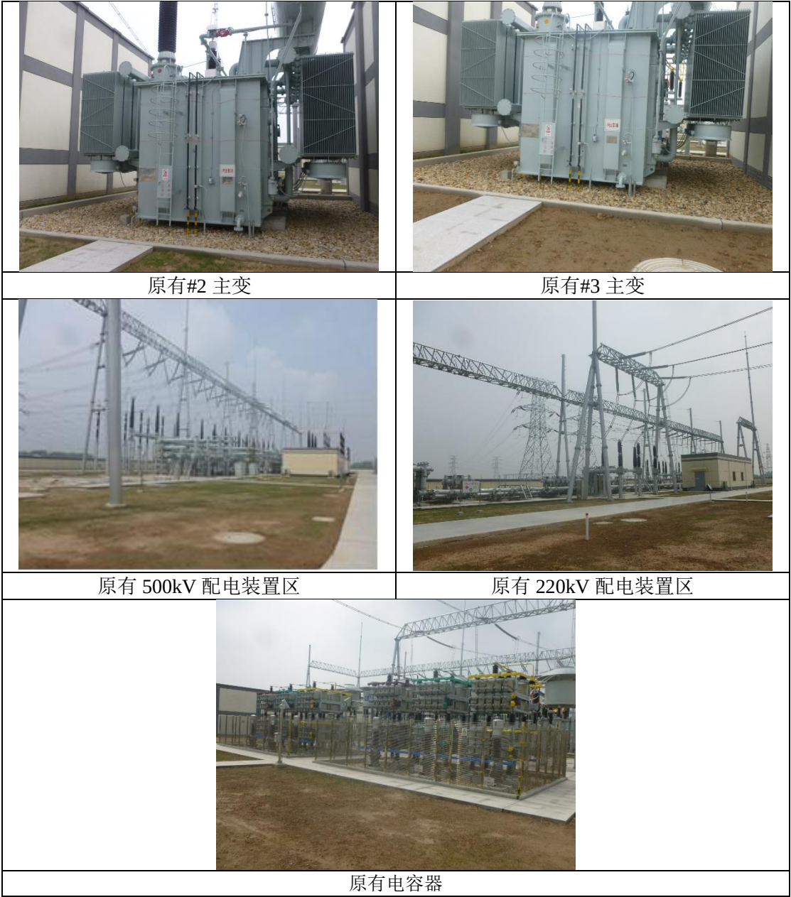
图 3-1 滨响 500kV 变电站原有工程
