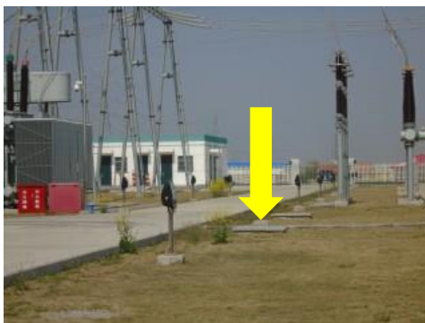
图 6-2 220kV 灌西变事故油池照片
