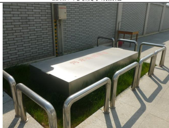
220kV 九墩变电站站内污水处理设施
