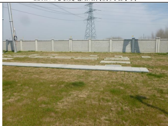
220kV 九墩变电站站内绿化示例
