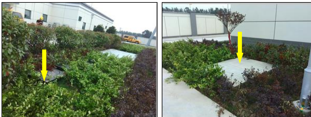
图 9-1 徐圩 500kV 变电站内地埋式生活污水处理装置
