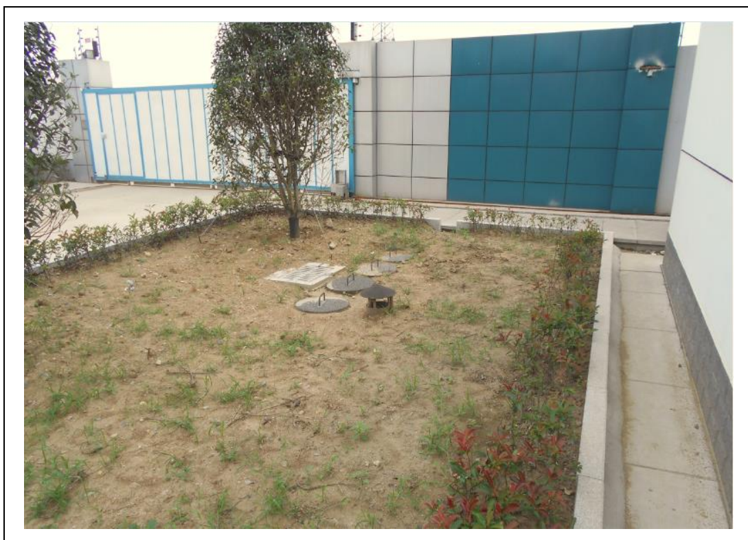
图 9.2-1 生活污水处理设施
