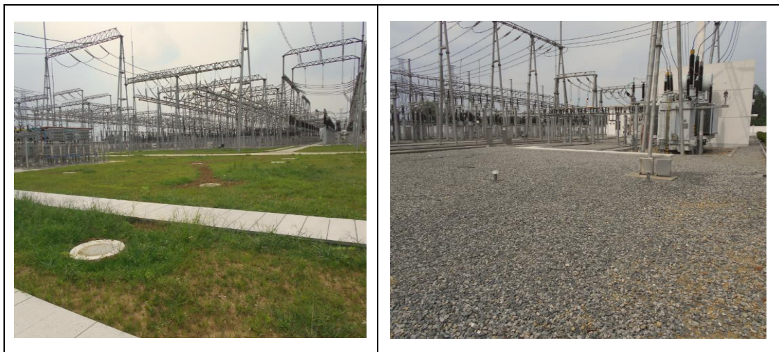
图 12.1-1 变电站内事故油池
