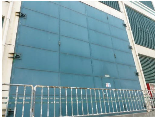
110kV 焦港变主变室隔声门设施示例
