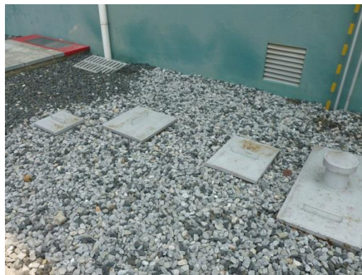
110kV 许庄变污水处理设施示例
