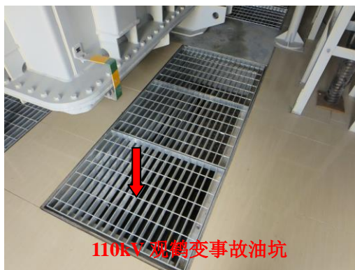
图 6-2 各 110kV 变电站事故油坑
