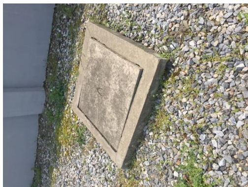
图 8-1 变电站事故油池图
