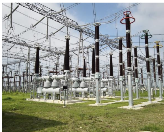
图 3-5 本期扩建 500kV 断路器
