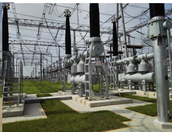
图 6-2 本期扩建 500kV 断路器场地绿化
