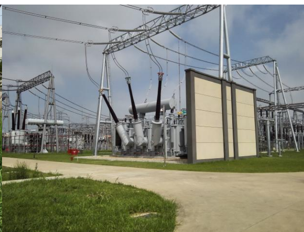
图 5-4 #3 主变东侧防火墙
