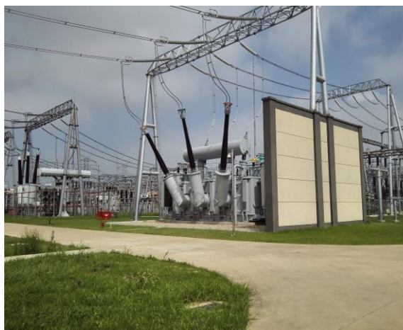
图 6-1 本期扩建 3#主变场地绿化
