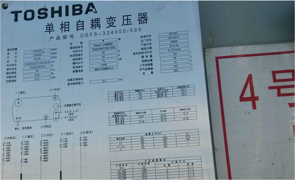
图 5.1 本期扩建#4 主变铭牌
