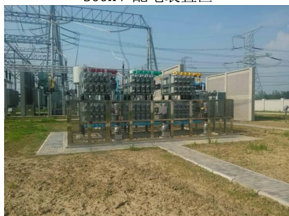
4#主变 电容器组（本期）
