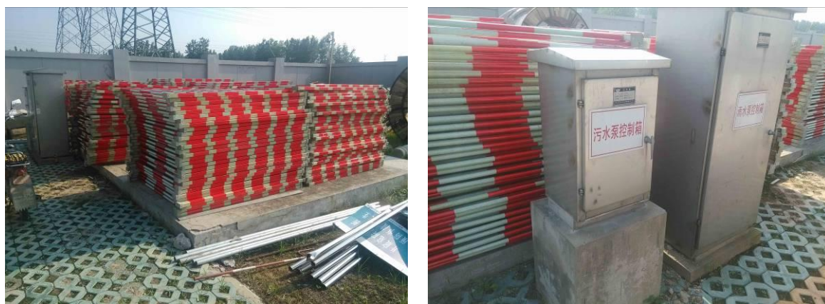
图 9.1 生活污水处理设施
