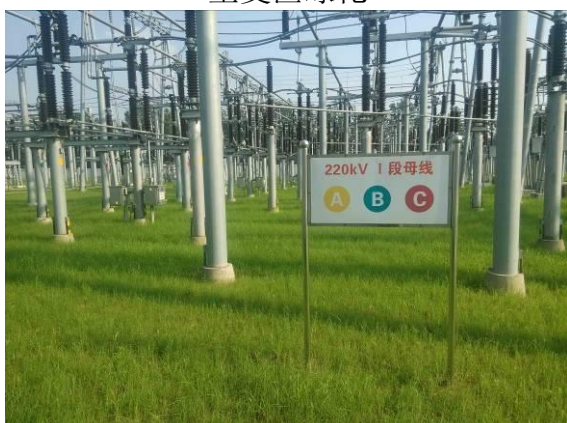
220kV 配电装置区绿化
