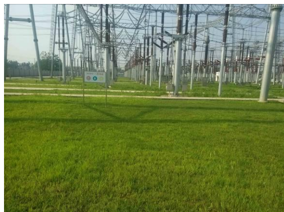
500kV 配电装置区绿化
