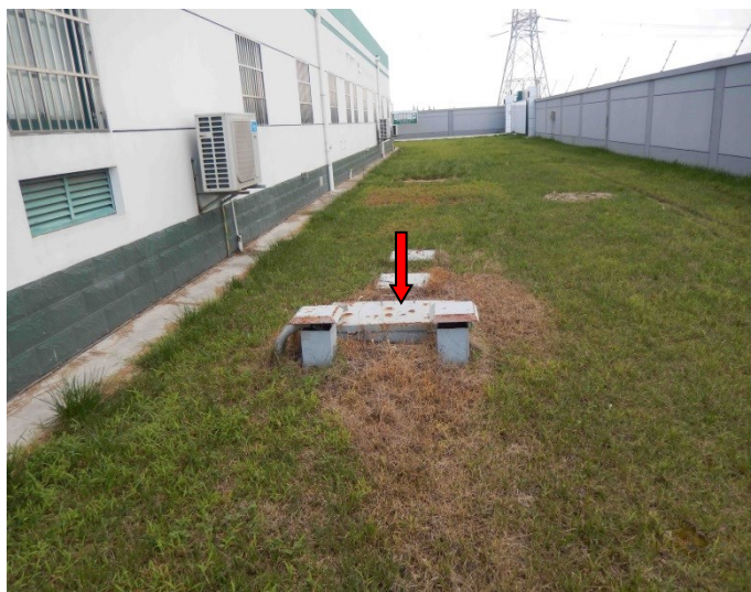
图 9-1 500kV 双草变电站内生活污水处理装置
