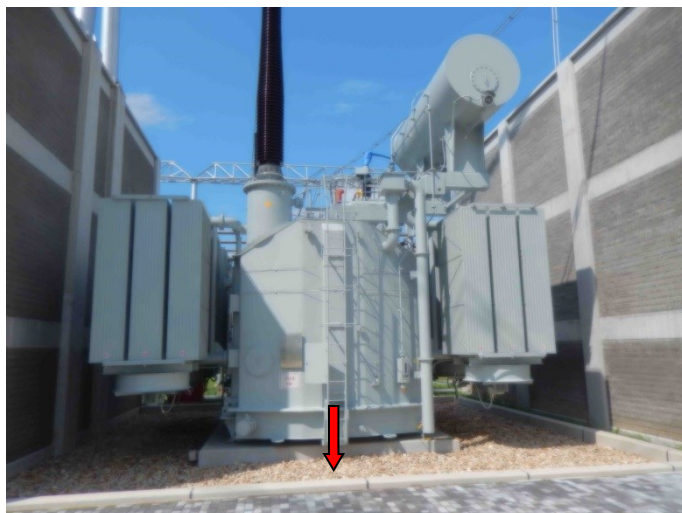
图 12-1 500kV 双草变电站本期#2 主变下方事故油坑
