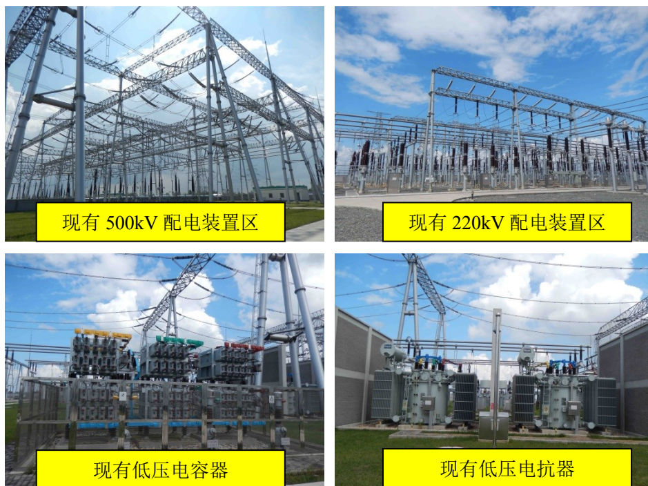
图 3-1 双草 500kV 变电站现有工程
