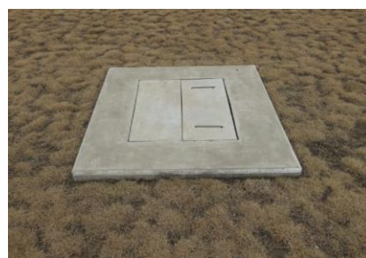
220kV 六圩变电站事故油池
