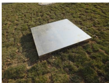
220kV 凤来变电站事故油池
