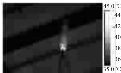
图 9 220 kV 母线悬挂绝缘子
