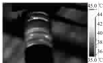
图 10 某刀闸 A 相支柱绝缘子
